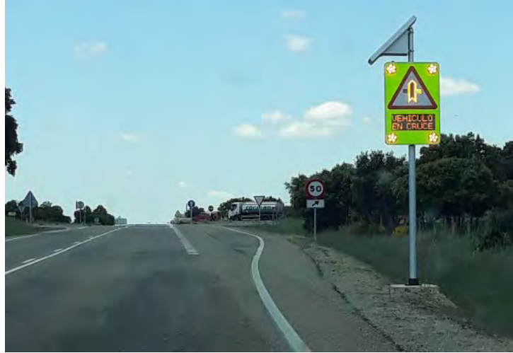
Señal de advertencia dinámica en carretera CL-517 pk 29+500.
