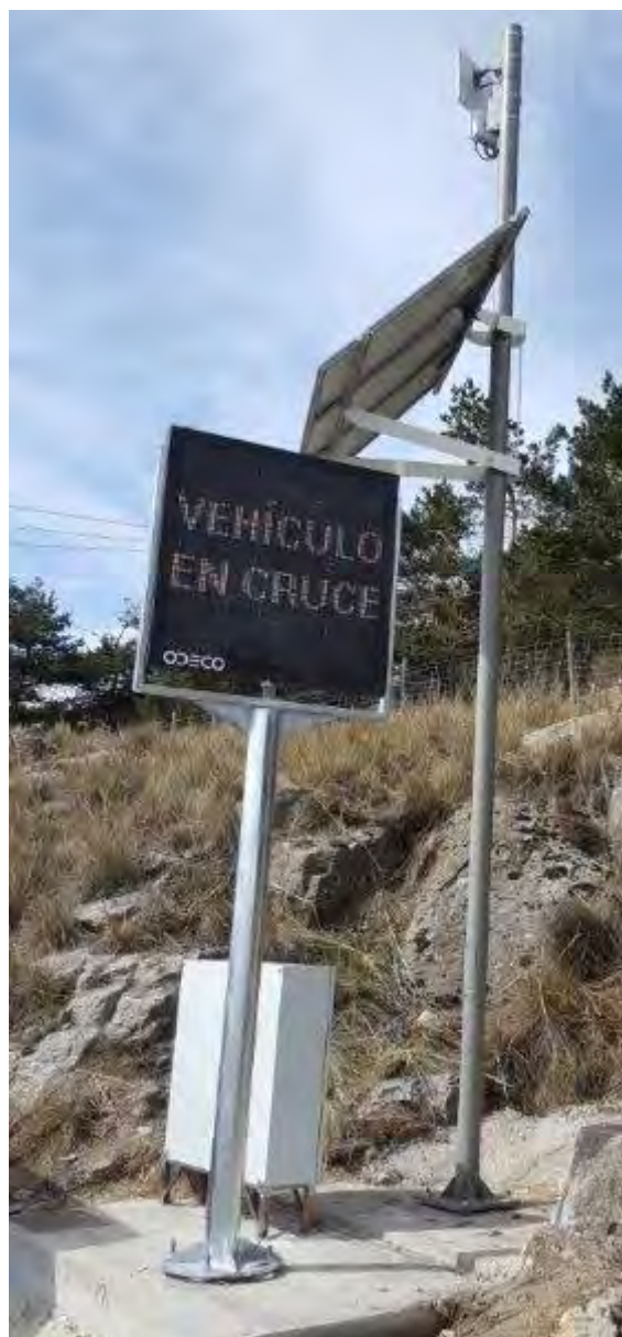
Panel de Mensaje Variable en carretera N-VI pk 57+000.
